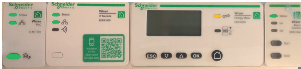
Figure 18: Vérification sur le module EMS
